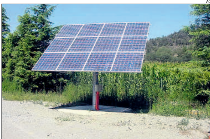
Montferrer disposa d'una planta solar a la depuradora.
