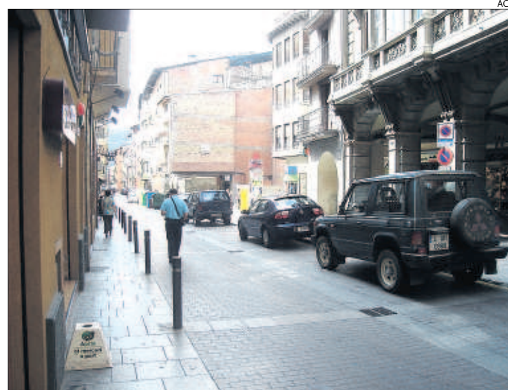
Paviment "feble" al carrer Major ■ L'ajuntament considera que el paviment es va instal·lar sense una base adequada, cosa que n'ha afavorit el deteriorament pel pas de vehicles pesants.
