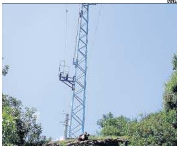
Línia de mitjana tensió que proveeix el municipi de Sort.
